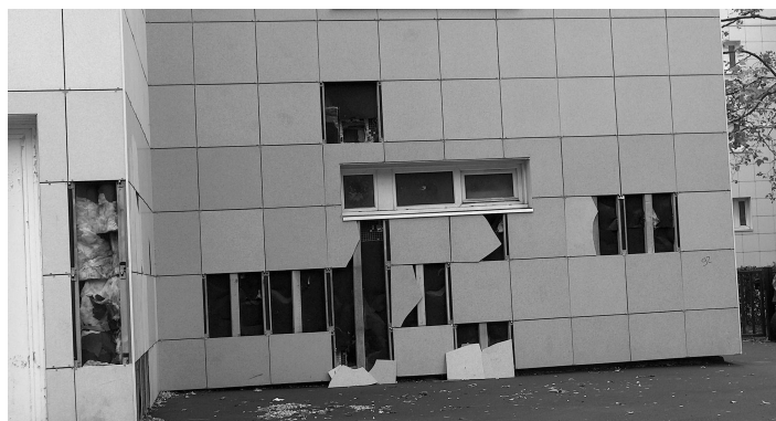
Le pied d'un des immeubles récemment réhabilités à la résidence HLM Guillebaud
